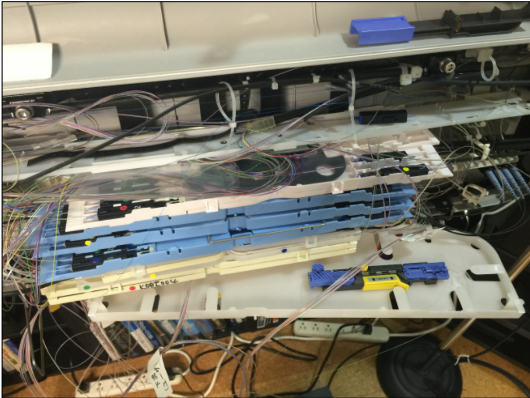
電柱上に吊ってある光ファイバと同様の「クロージャ」を分解した様子。 スプリッタが入っていて、ここで 8 分岐している
