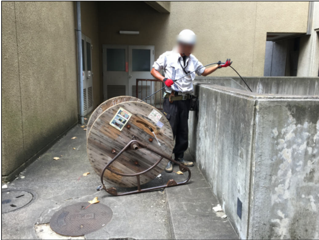
筑波大学の地下共同溝に光ファイバを注入するための樽
