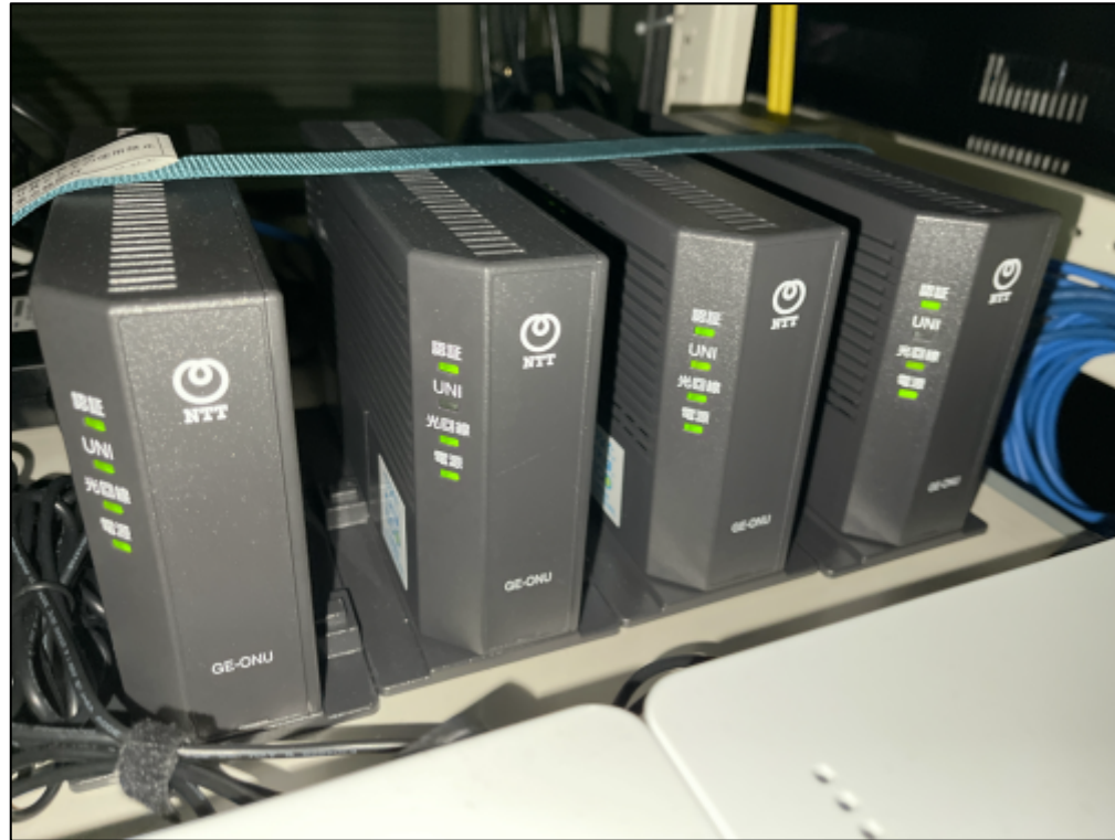
フレッツの GE-PON ONU (宅内装置)。 写真は、筑波大学学情センターに立ち並ぶ大量の ONU
