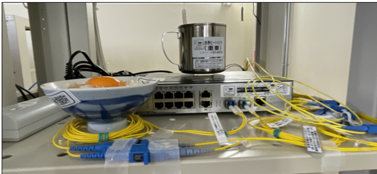
PPPoE 網終端装置と接続されている ISP 側の通信装置設置用棚 (ソフトイーサ株式会社提供)
