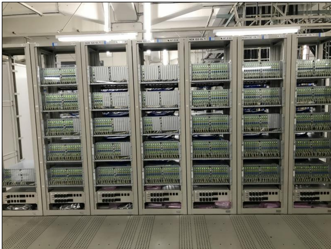
フレッツの GE-PON OLT (局側装置)。 写真は、NTT つくばビルに立ち並ぶ大量の OLT。 皆さんのつくばエリアの自宅の GE-PON ONU もここに収容されている
