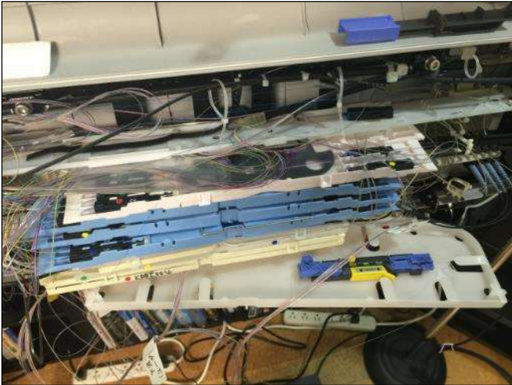
電柱上に吊ってある光ファイバと同様の「クロージャ」を分解した様子。 スプリッタが入っていて、ここで 8 分岐している
